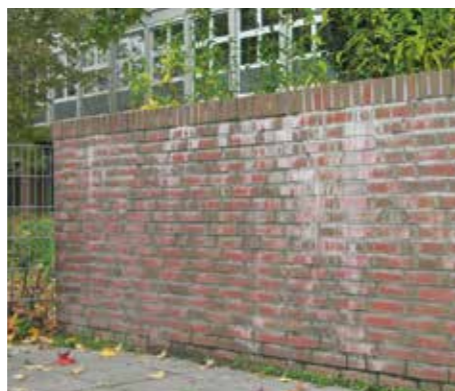
So bitte nicht: Die Oberkante dieser Mauer wurde manuell erstellt. Die Folge: Regenwasser dringt ins Mauerwerk ein und verursacht hässliche Auslaugungen. Mit einer vorgefertigten Mauerwerksabdeckung von Röben wäre das nicht passiert.
